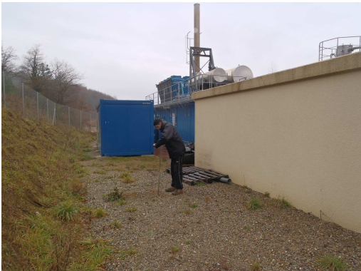
Prélèvement amont valorisation biogaz
